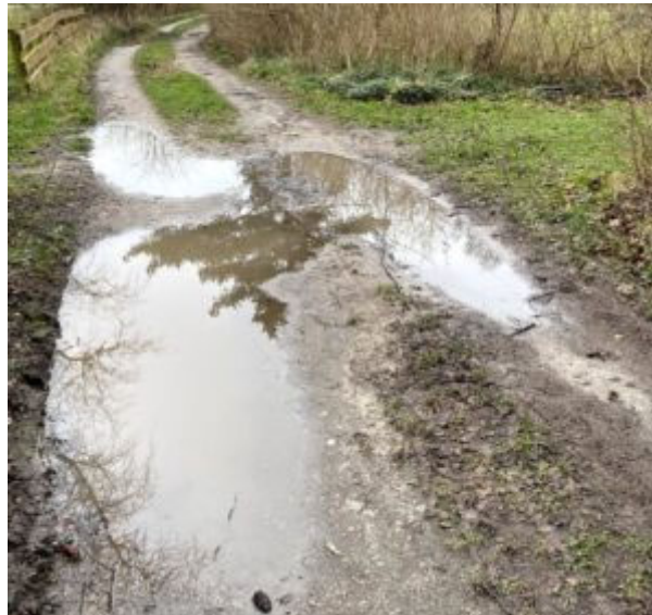
Dårlig afvanding ødelægger vejen
